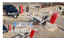
Barrera de control de acceso por matrícula
